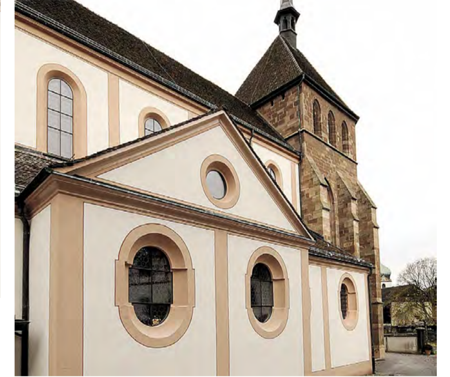
Was vorher rosa war, ist jetzt weiss und umgekehrt. Die Fenster erhielten ausserdem eine Schutzverglasung.
